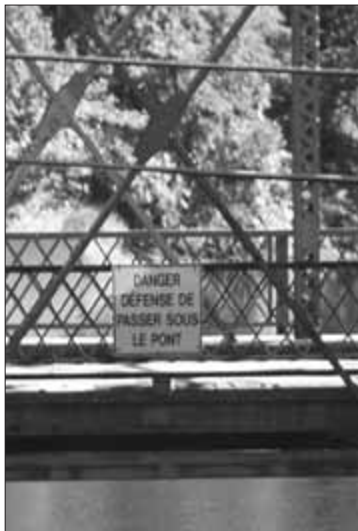
Vue du pont Shaw à partir de la 117. On y voit l'inscription : « Danger - Défense de passer sous le pont ». À quand l'interdiction de voler au-dessus du pont Shaw?
