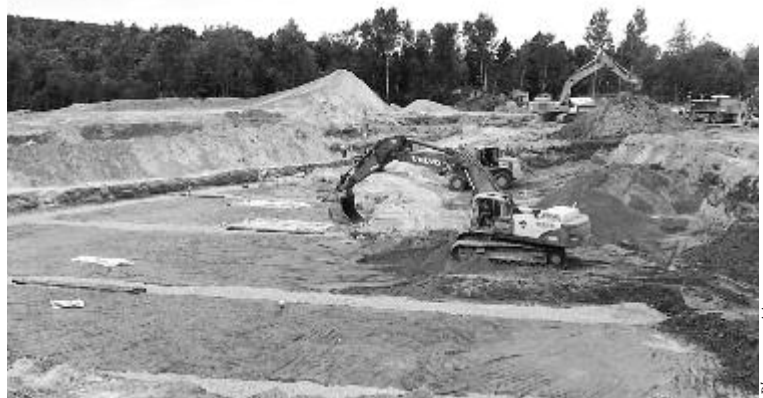
Le chantier de construction du troisième étang aéré de l'usine d'épuration de Prévost.
